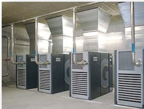
Centrale air comprimé 4000m 3 /h à 7,5 bars dont un compresseur à variation de vitesse
