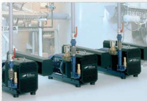
Centrale de vide
